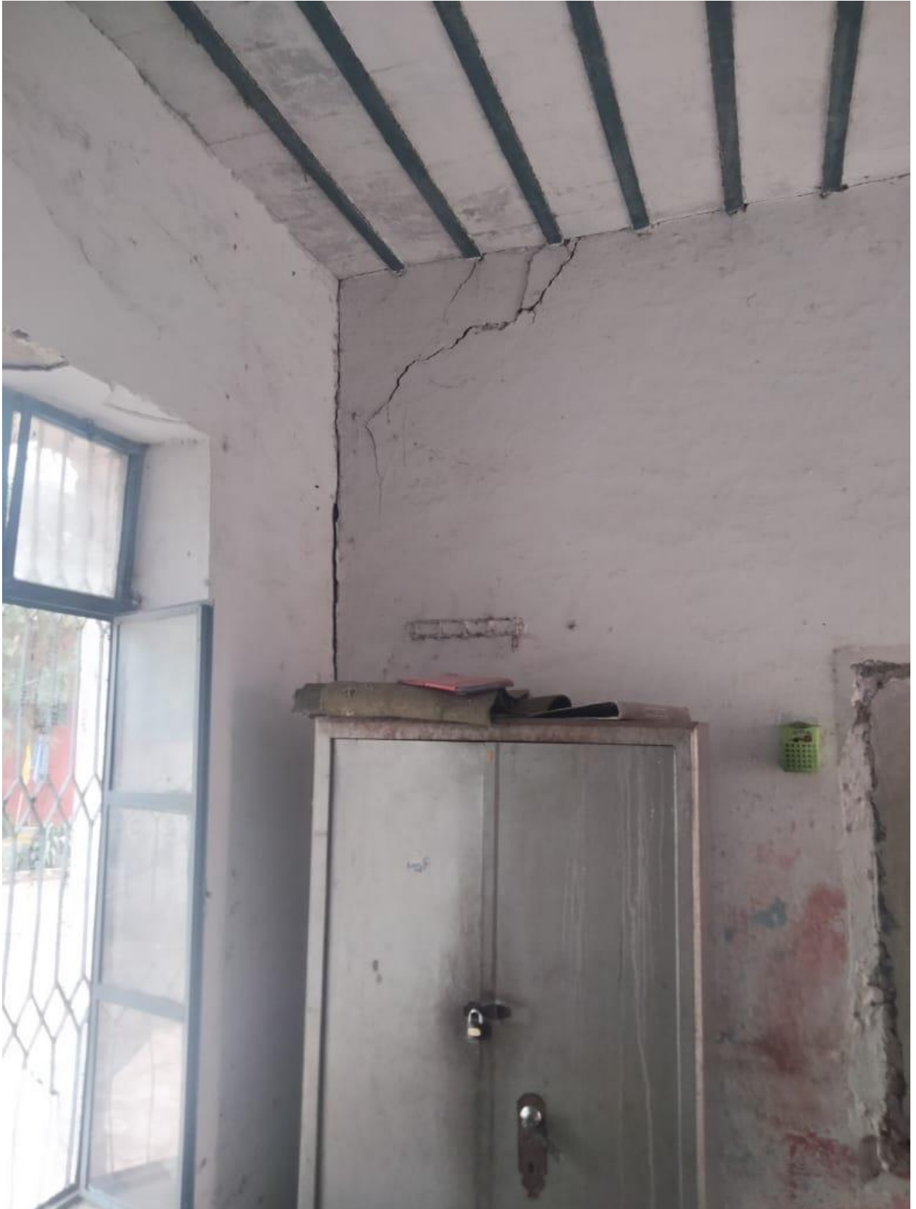
Aule segnate dal degrado strutturale
