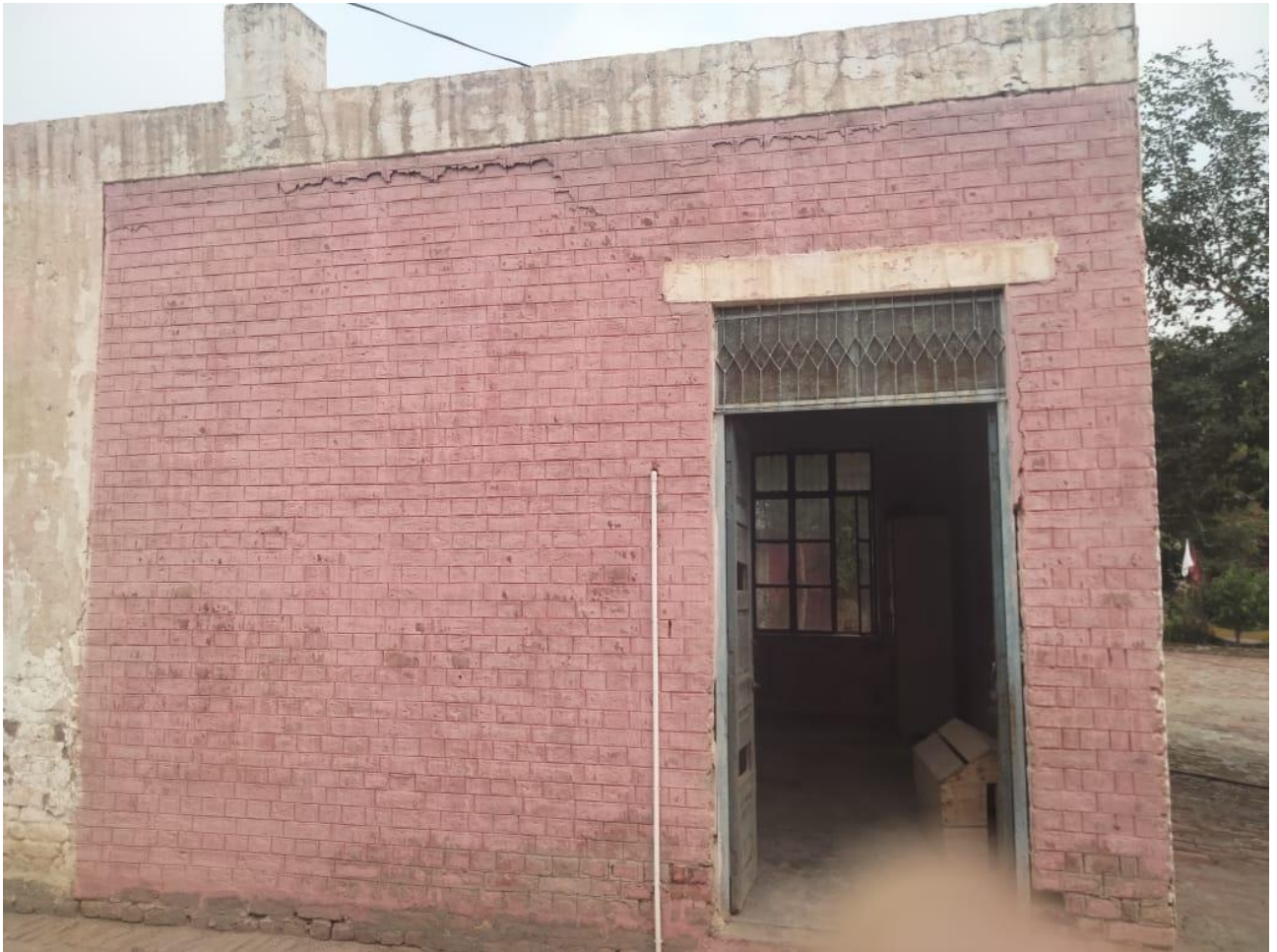
Struttura muraria degradata
